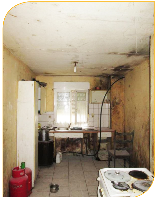
Logement insalubre. Source : ARS
